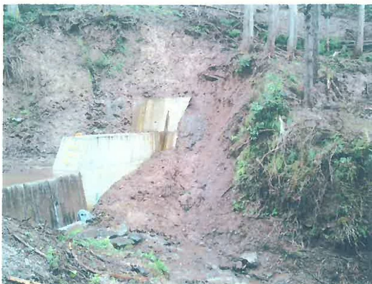
川原ヶ谷治山砂防堰堤 の左岸袖部法面の崩壊
