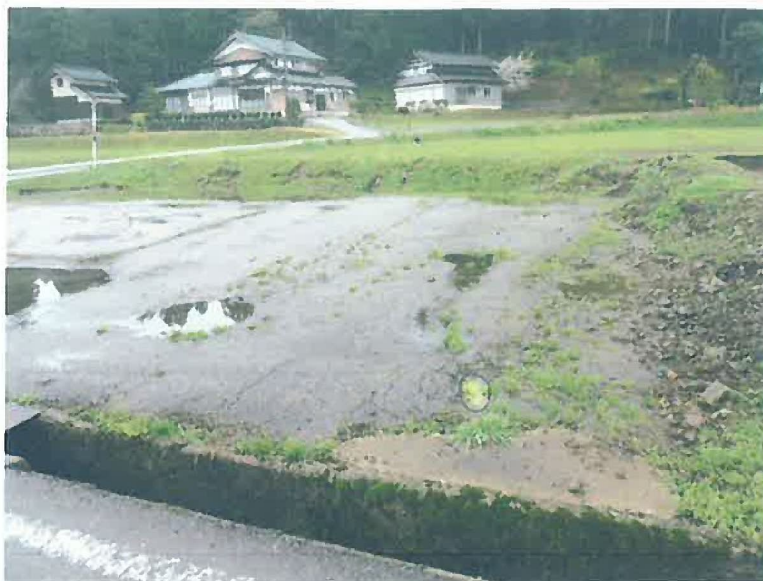
防火水槽周辺の陥没 (第4区)
