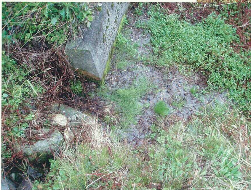
②水が流出する様子（道路から見下ろす。）
