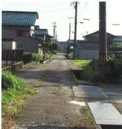
⑦天神町2号線 流雪溝水量少なく、すぐ詰まる。 流雪出来ない。
