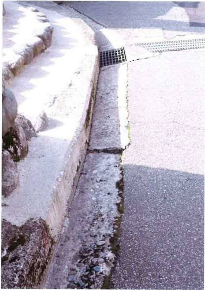
階段-道路 ひび割れ、沈下状況 ③
