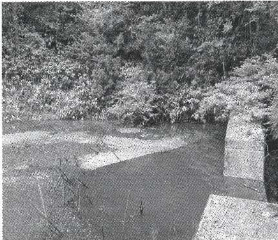
堆積汚泥状況 1
