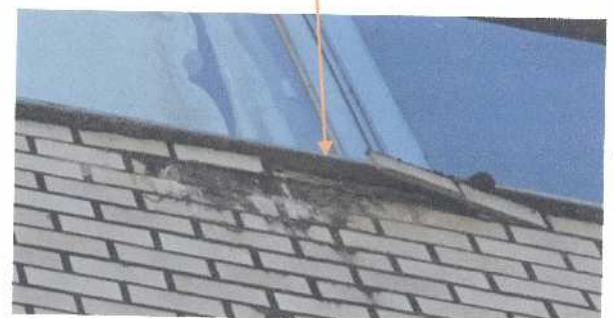
壁の各所にあるタイル剥がれ 落下した部分もあり、下は歩 道で、人が通る為当たればけ がとなる・・・(エ方面の壁)
