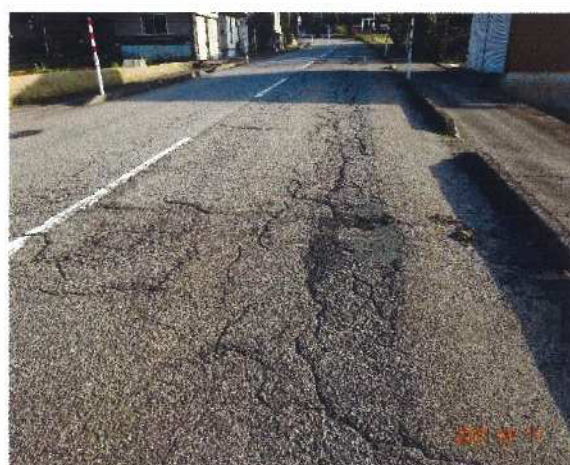
④ 国道304号線 道路の劣化(前田久夫宅～松川均宅)
