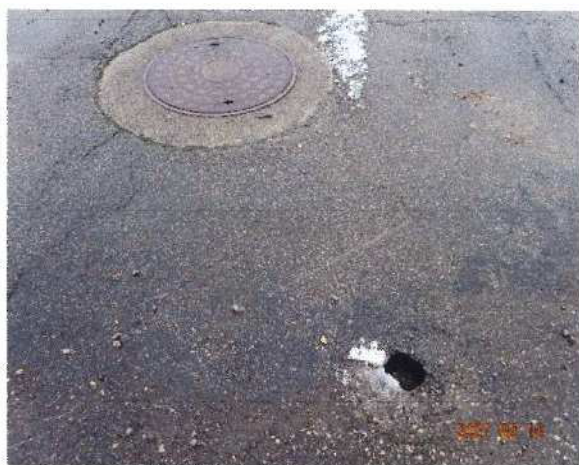
③ 松本誠一宅下交差点 道路中央陥没および周辺沈み込みあり
