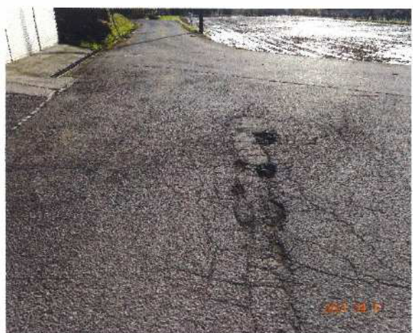
⑤ 山田雅彦宅付近 道路破損
