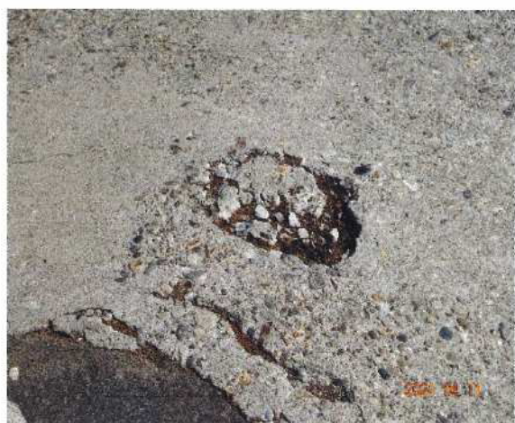
① (旧)打尾橋 橋上流側 道路中央陥没(破損)
