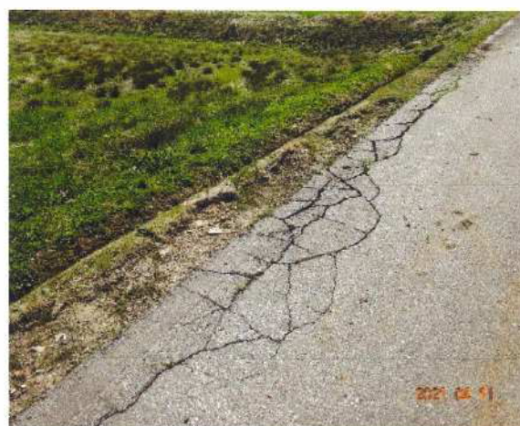
⑥ 山田良昭宅南側道路 除雪車の重量による路肩破損
