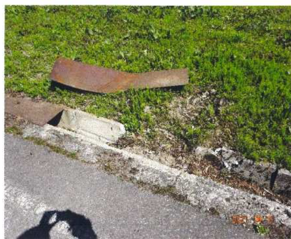
② 今井隆宅前 U字溝及び鉄板の破損
