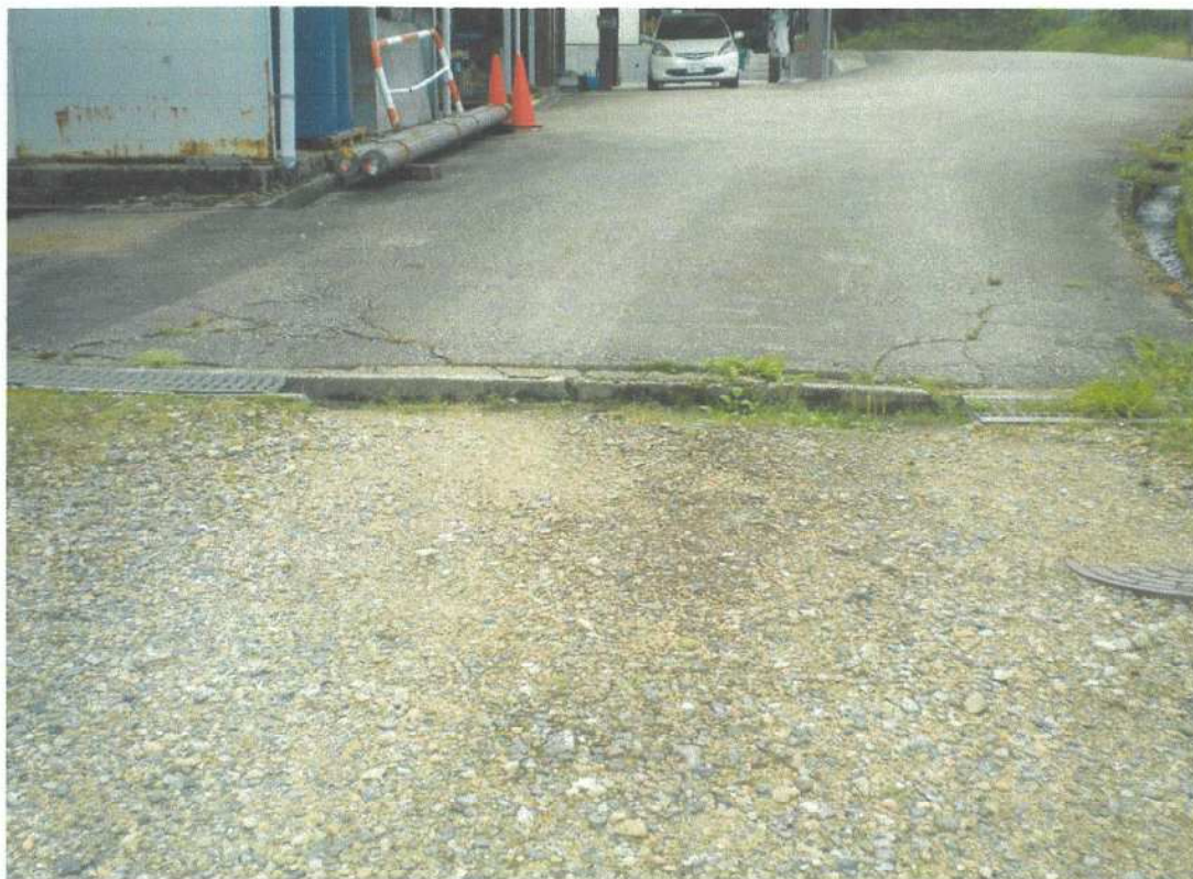
側溝の損傷と段差 ①
