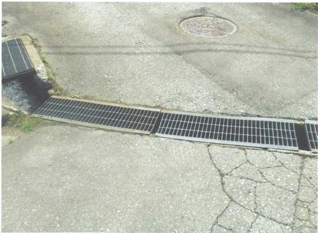
現有舗装の損傷箇所 ②
