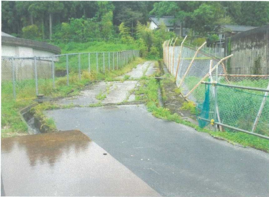
現有舗装の損傷箇所 ①
