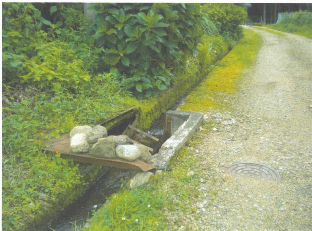
側溝の損傷 ②
