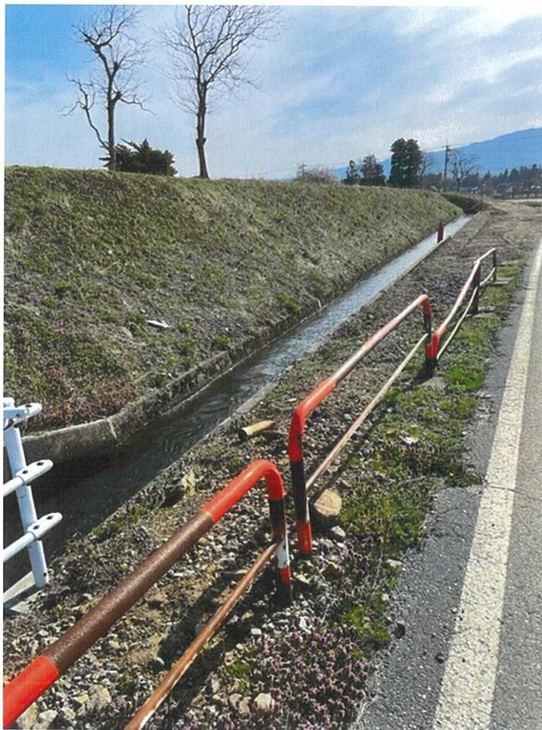
用水転落防止策がなされていない箇所
