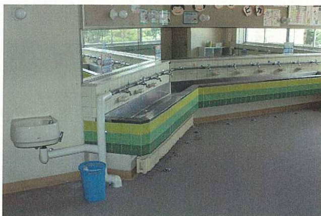
配管の水漏れが激しく、全体をやり直した 二階洗面所
