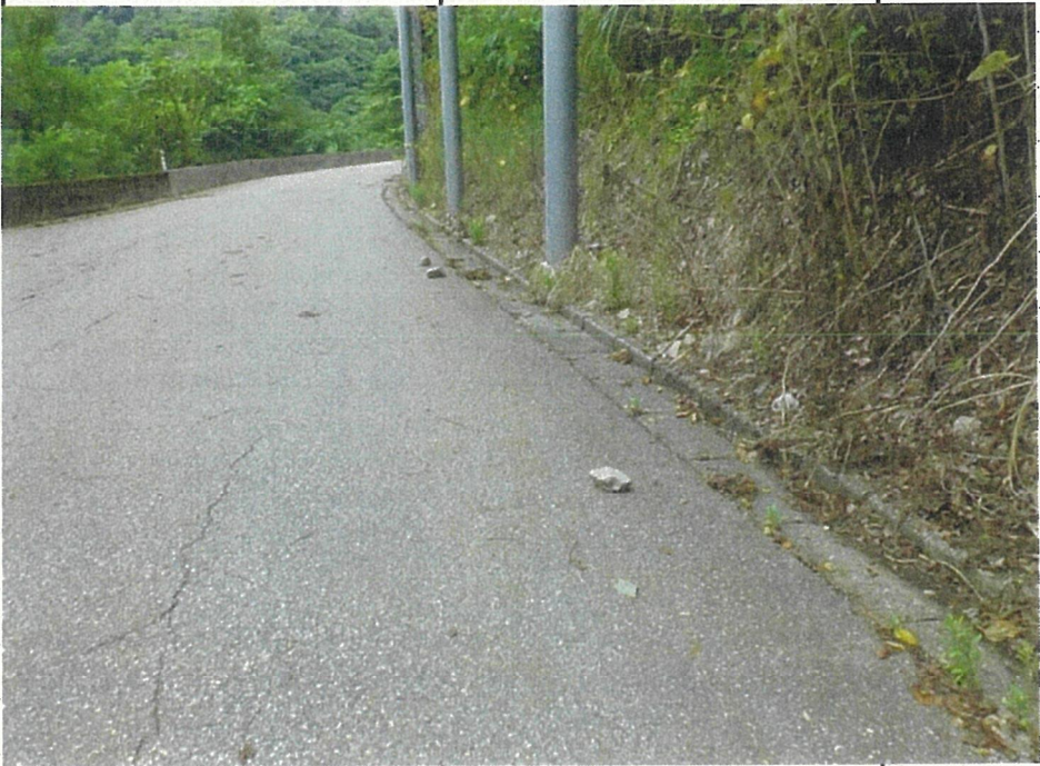
清水谷国道側落石防止策 ネットが取り付けられ ていない
