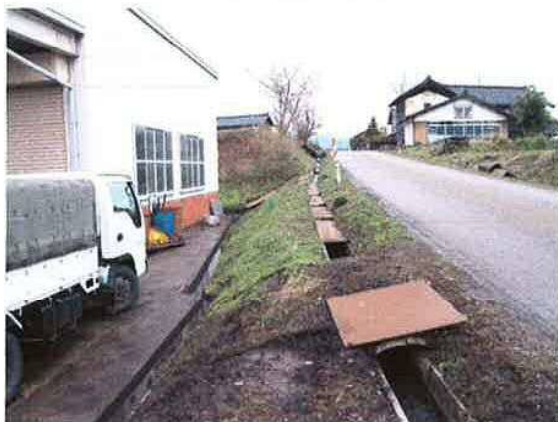
写真2 今年冬の被害状況
