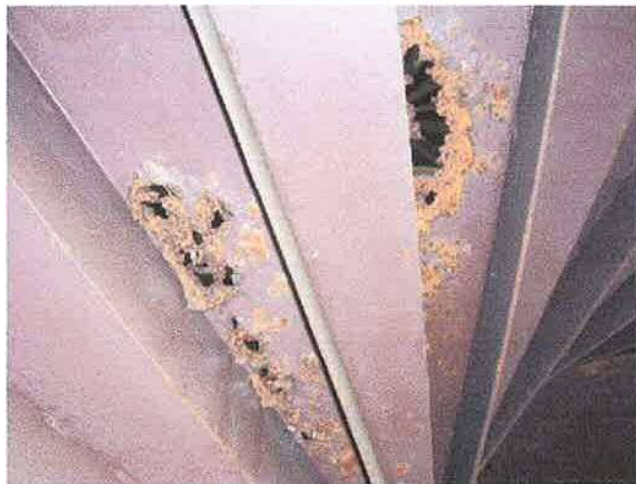
2-①坂上公民館非常階段上部 踏み板部がさびで崩落状態になっている。
