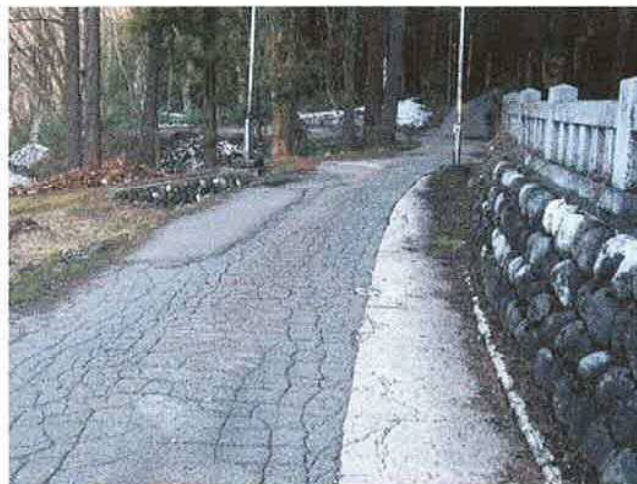
1-①藤巻線 終点側⇒起点側4 路面補修要望
