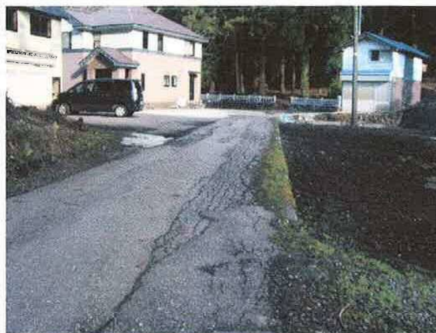
1-①藤巻線 終点側⇒起点側2 路面補修要望
