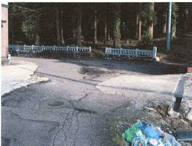
1-①藤巻線 終点側⇒起点側3 路面補修要望
