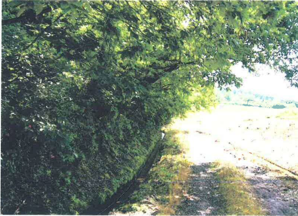
道路上に雑木が出ている
