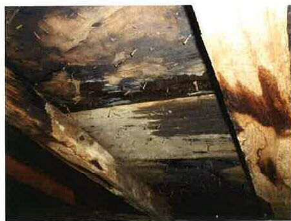
腐朽の進む部分
