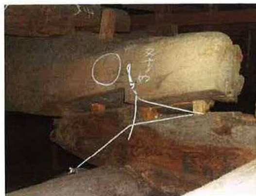
経年破損箇所
