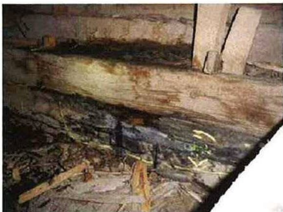
腐朽修繕が必要な箇所
