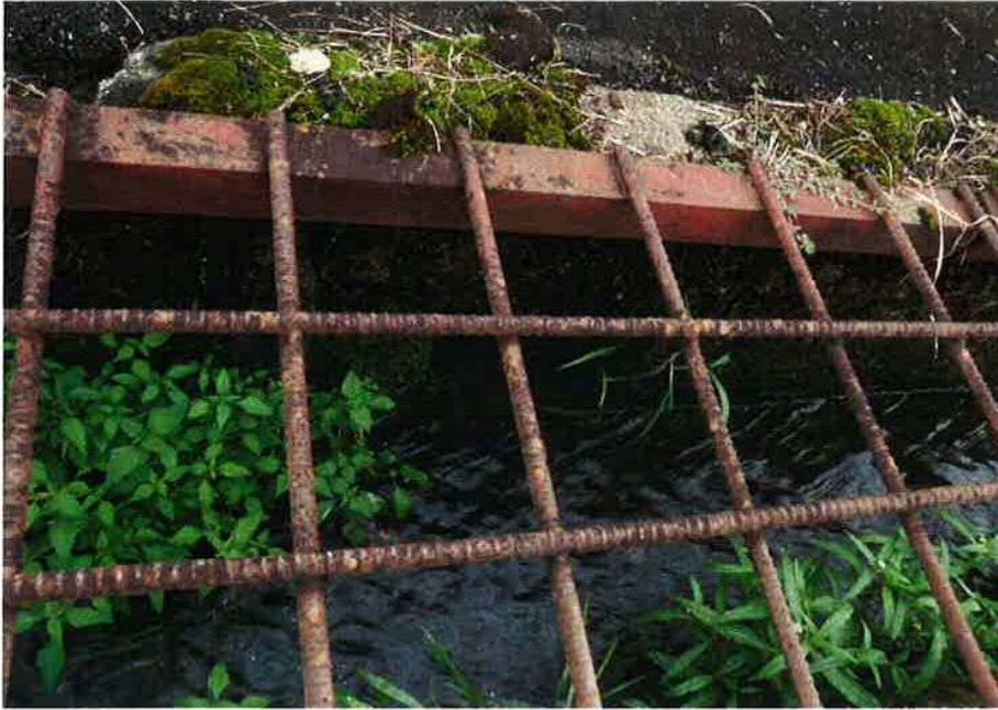
専勝寺院瀬見線 沖地内側溝老朽化
