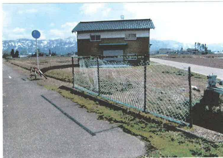
用水路柵現況（破損状況）
