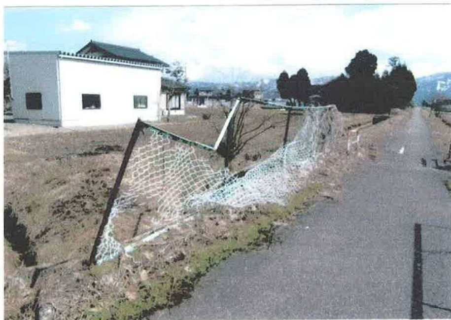
用水路柵現況（破損状況）
