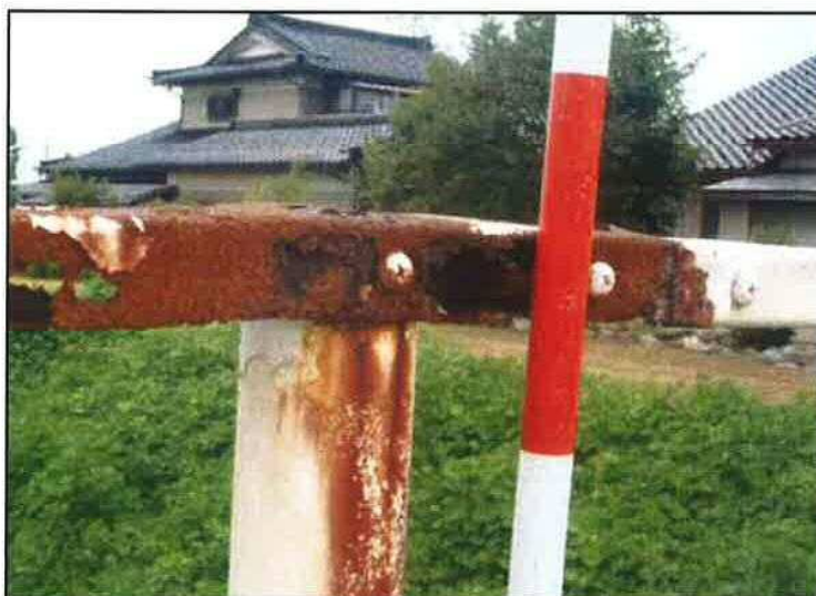
位置: 防護柵 腐食
