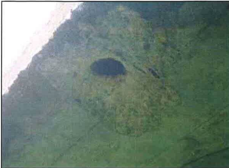
位置： 床版防護柵下 欠損
