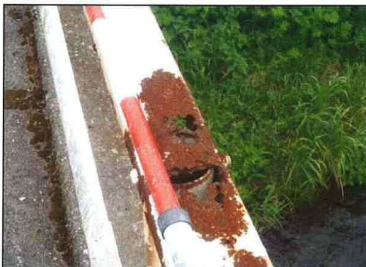
位置: 防護柵 腐食
