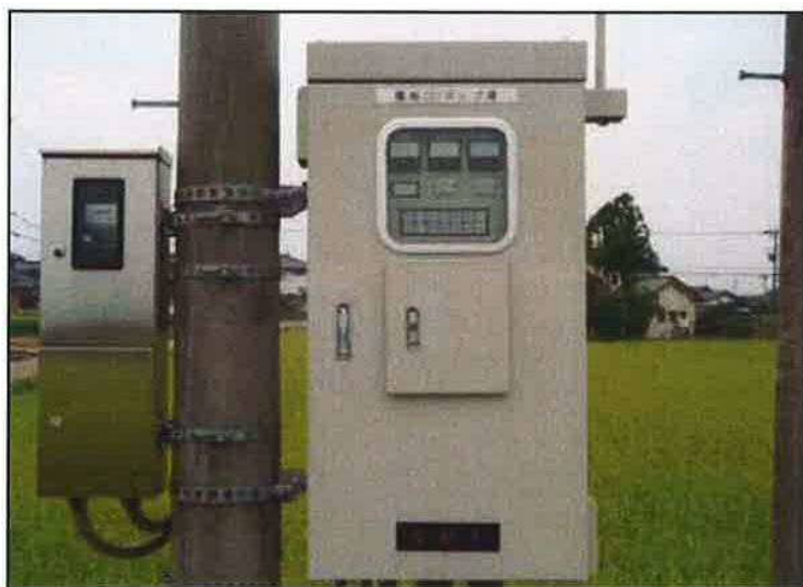
位置: 下水ポンプ制御盤
