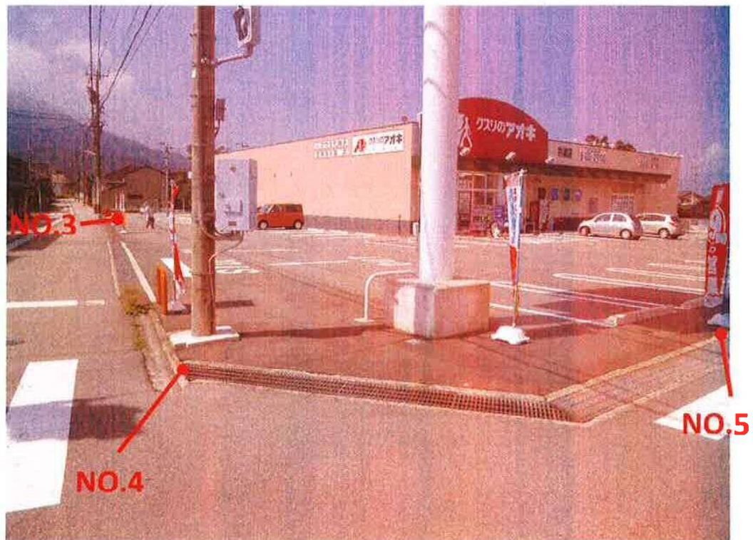
区間 NO. 4～NO. 5 側溝状況（改良未実施）
