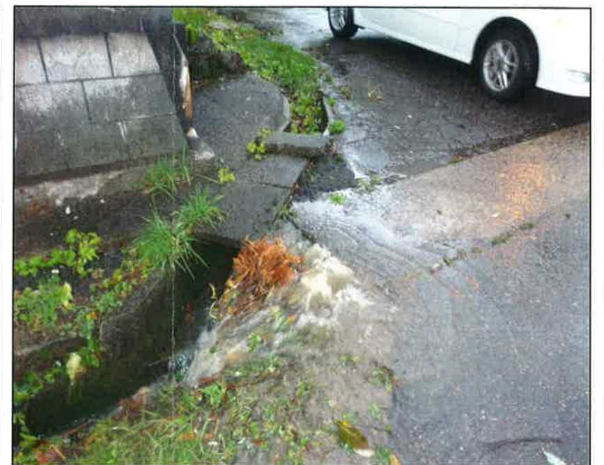
②市道志観寺山見線 交差点合流部 側溝溢水状況
