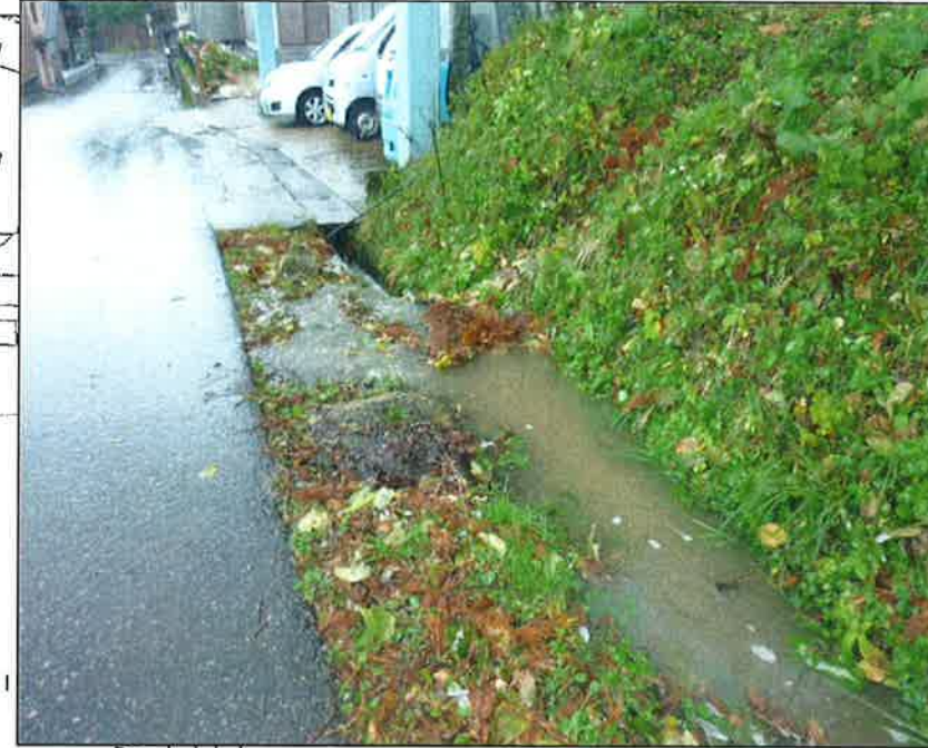
①市道山見坪野2号線 野村鉄工所前 側溝溢水状況
