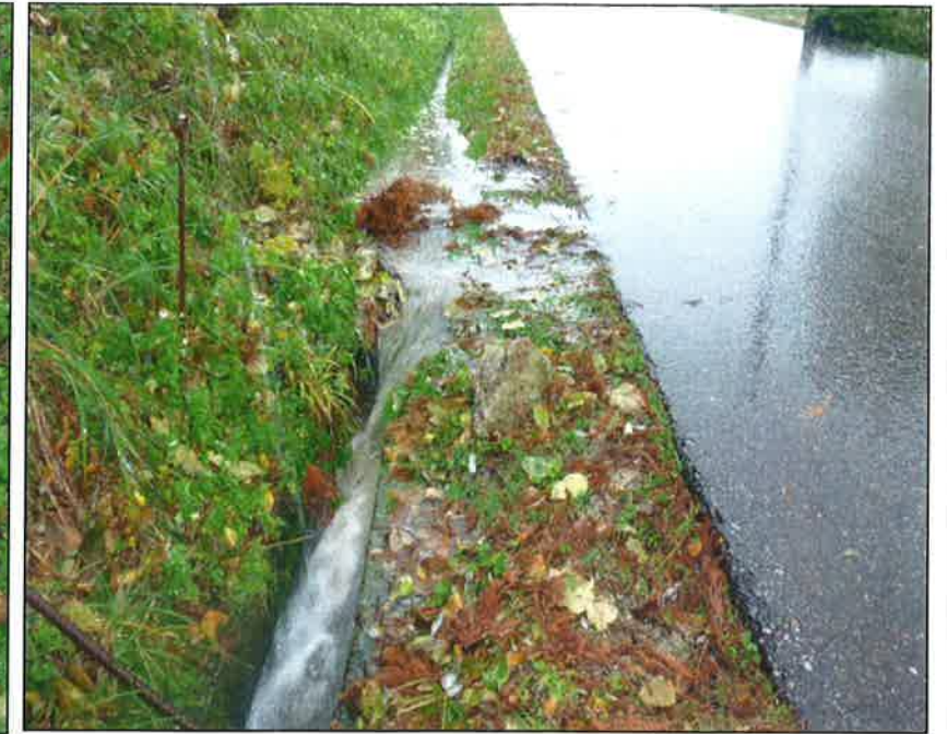
①市道山見坪野2号線 野村鉄工所前 側溝溢水状況
