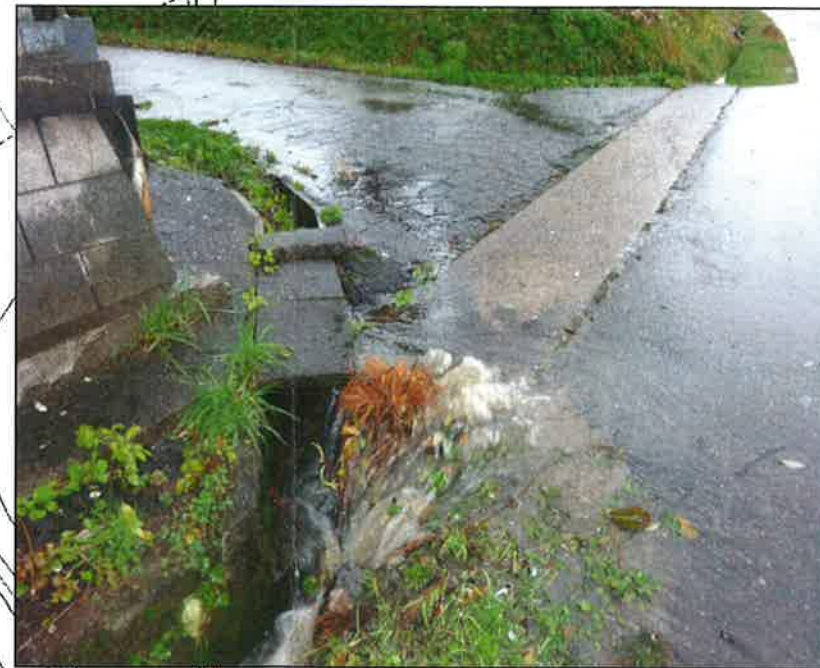
②市道志観寺山見線 交差点合流部 側溝溢水状況
