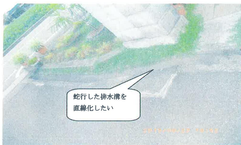
排水溝が一部蛇行している
